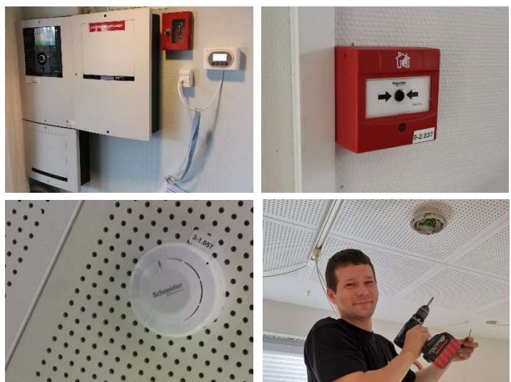
Funder Plejecenter fik den 30. september 2019 installeret nyt og forbedret ABA-anlæg af Henning Mortensen a/s.
